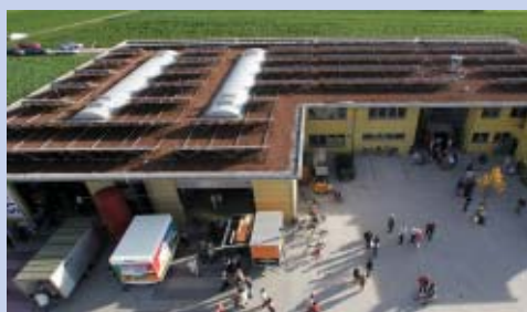
342 monokristalline Solarstrommodule und 20 Dünnschichtmodule sind auf dem Sonnen-Zentrum installiert. Insgesamt haben sie eine Spitzenleistung von 58,1 kWp.
